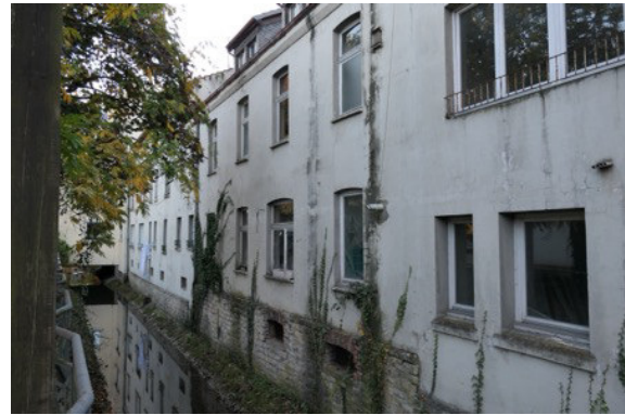
Abb. 8 Gebäude mit erheblichem Sanierungsbedarf Südwall 1-7 (Bildquelle: scheuven + wachten plus)
