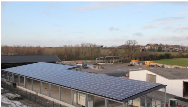
Abbildung 5: PV-Anlage auf der Fahrzeughalle
